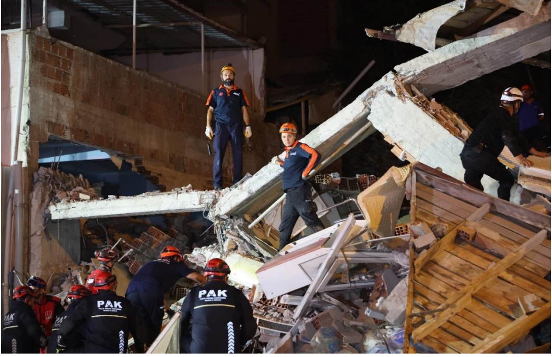
Şekil 3. 2. Yıkılan binanın detay görünümü
