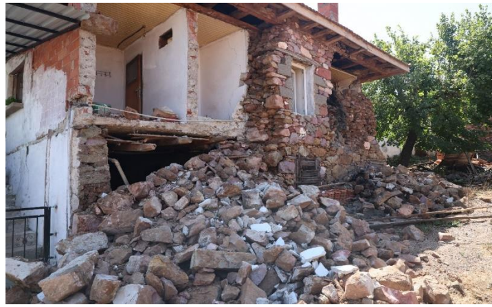
Şekil 3. 3. Köy tipi, toprak harç malzemesi kullanılan hasarlı binalar
